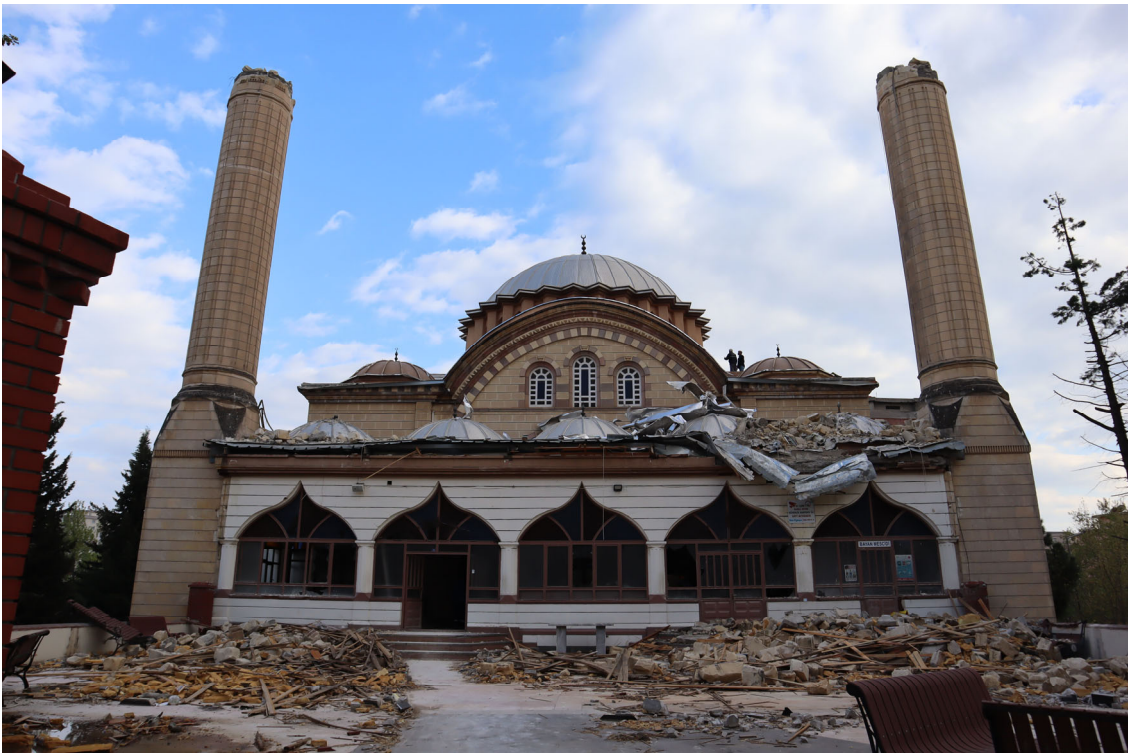
Photo 1-10 Onikişubat, K.Maraş. Hz. Yunus Cami. Collapse of minarets.
