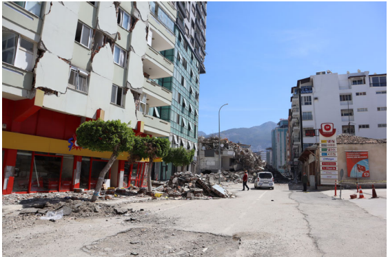
写真 1-58 ハタイ県イスケンデルン地区 奥には 12 階建て集合住宅が倒壊している
