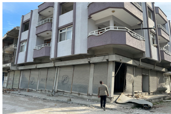
写真 1-53 ハタイ県サマンダー地区 層崩壊している建物
