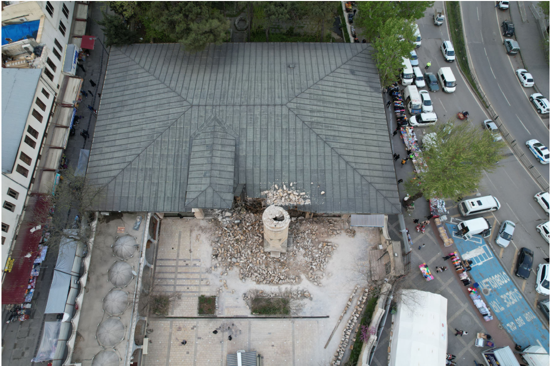
写真 5-12 ミナレットが倒壊して石が落下することで、建物が損傷していることがわかる
