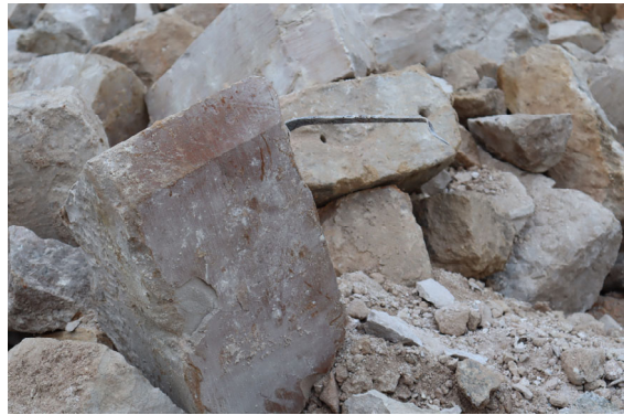
写真 5-9 倒壊したミナレットの石の鉄製つなぎ材
