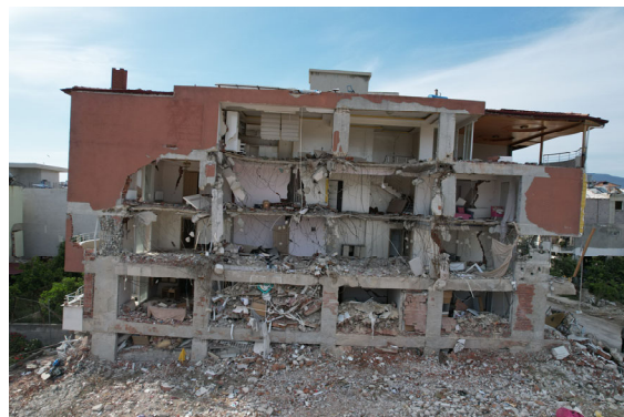
写真 1-51 ハタイ県サマンダー地区 これは元々は6階建ての集合住宅 1階と2階が潰れている
