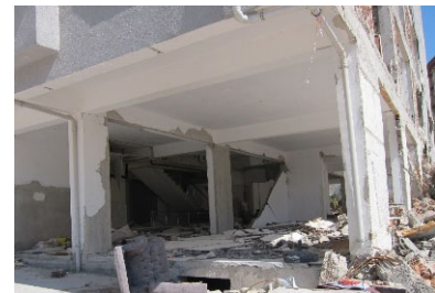
写真 3-3 間口方向に扁平化された柱
