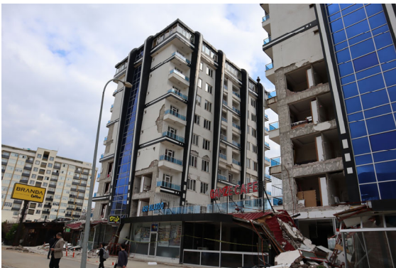
写真 1-4 カフラマンマラシュ県オニキシュバト地区 集合住宅 外壁の剥落
