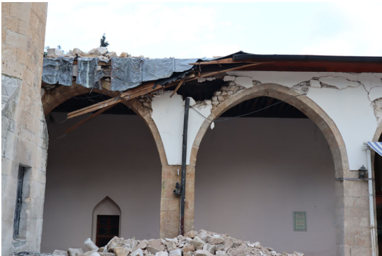
写真 5-3 損傷したポルティコ
