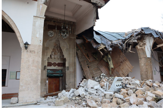
写真 5-2 エントランス付近が損傷している
