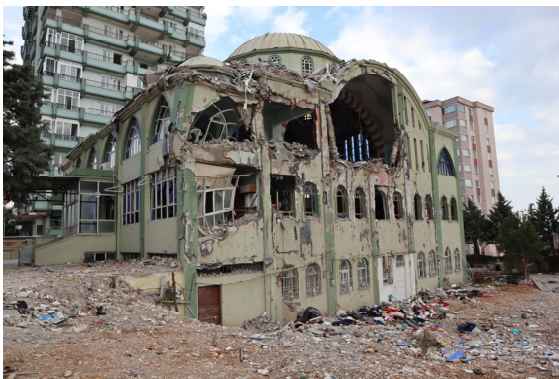
写真 1-8 カフラマンマラシュ県オニキシュバト地区 HACI HUSEYIN KARA CAMARA CAMII 隣の建物が倒壊し、ジャーミイも損傷した
