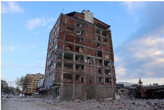
写真 1-12 カフラマンマラシュ県ドゥルカディオール地区 外壁ブロックの落下
