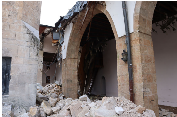
写真 5-4 損傷したポルティコ
