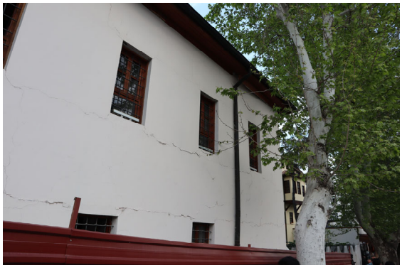
写真 5-16 外壁 ひびが入っている
