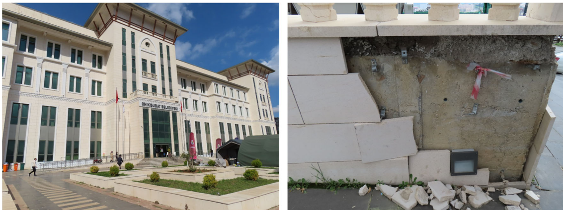
図 2-15 Kahramanmaras の地震被害状況(地点①)
