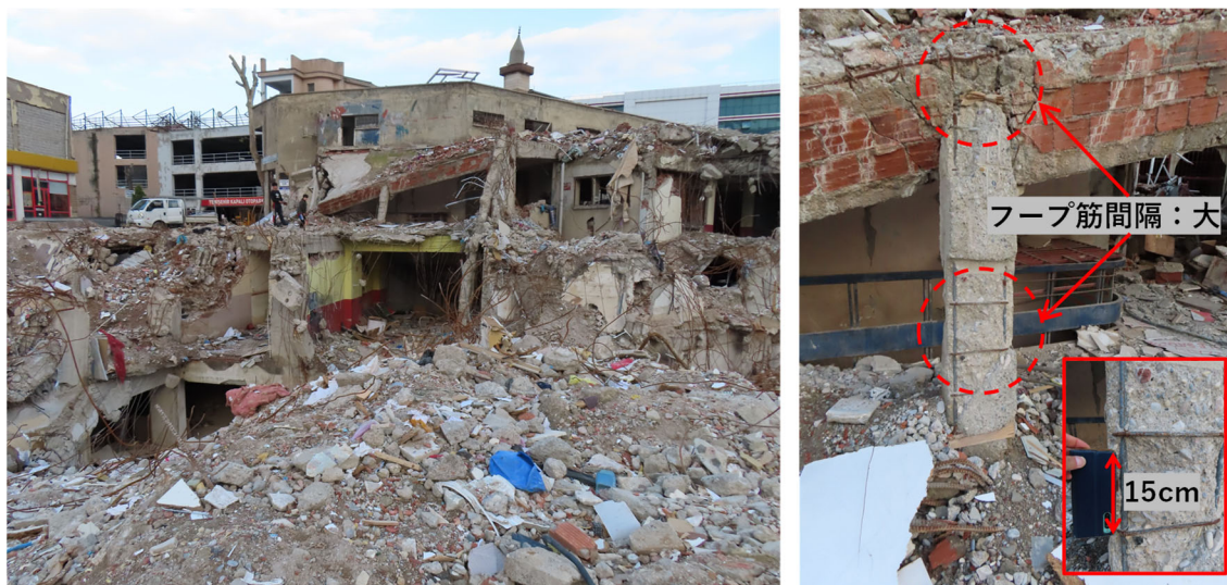
図 2-19 Kahramanmaras の地震被害状況(地点⑤)
