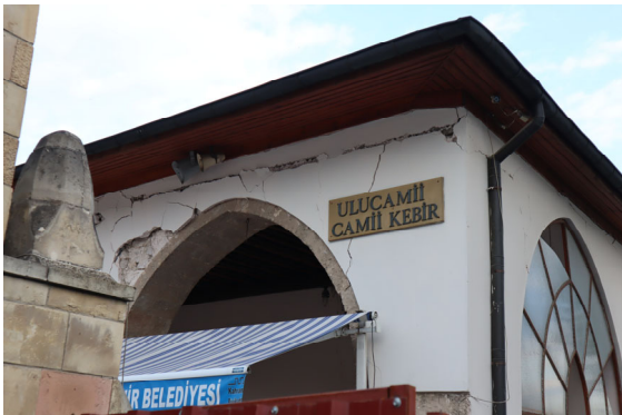
写真 5-15 外壁 ひびが入っている
