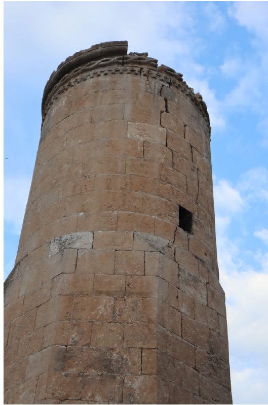
写真 5-7 ミナレットにひびが入っている
