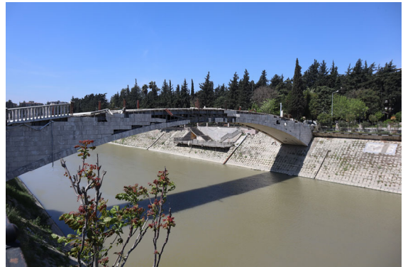
写真 1-27 ハタイ県アンタキヤ地区 橋の仕上げ材の剥落
