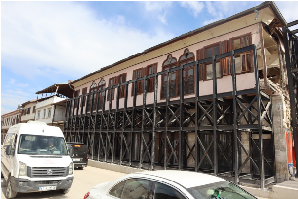
クルトゥルシュ通りの文化財建造物。倒壊しないように鉄骨で支えている。
