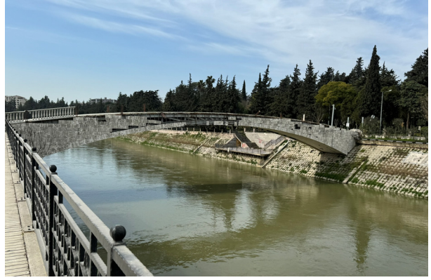
地震で欄干が壊れた橋。現在も人が橋を渡っている。
