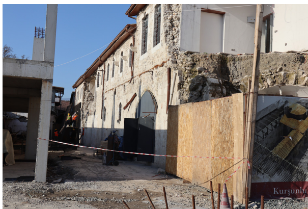
クルシュンル・ハンの修復現場。保全用の足場を組んでいる。
