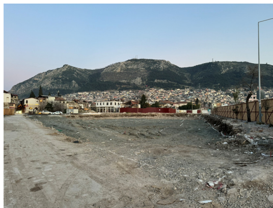
ウズンチャルシュの倒壊現場。これから工事が始まろうとしている。
