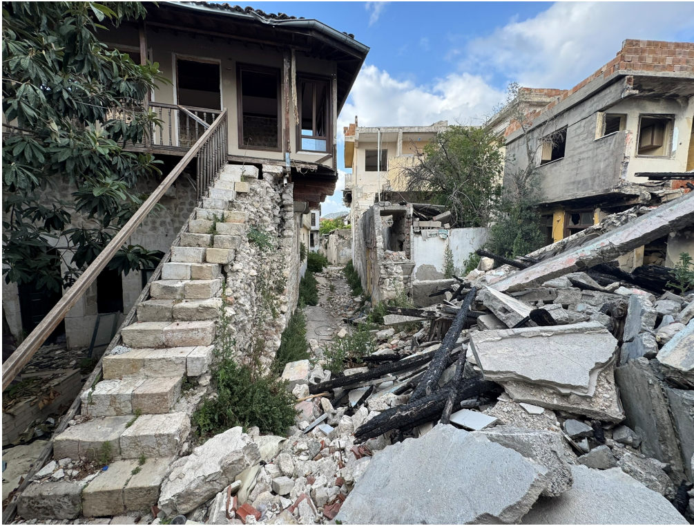
住宅の復興は進んでいない。壊れたまま放置されている。
