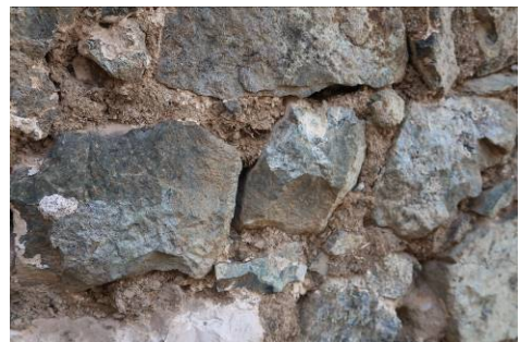
貧弱なアース・モルタル
