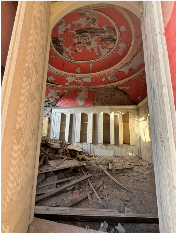
主室の天井はテクネタバンと呼ばれる折り上げ天井。 壁にはマフメルと呼ばれる壁内収納がある。危なくて立ち入れない。
