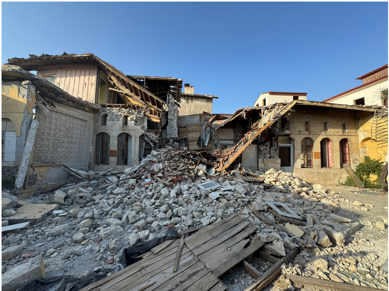
今回対象の伝統的住宅建築（文化遺産）。調査直前に崩壊がかなり進んでしまった。左から右に第三室、第二室、そして主室が並ぶが、中央の第二室は完全に崩壊しており原型を留めていない。
